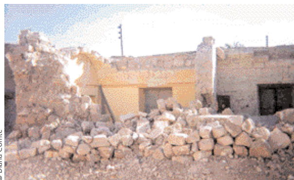
Dégâts au Nord Chili peu après le séisme du 23 juin 2001.
