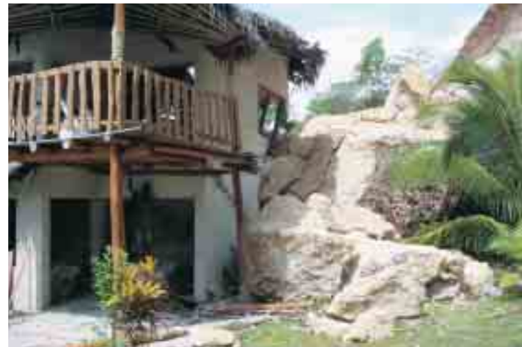
Conséquences du séisme qui a touché Port Vila au Vanuatu en 2002.
